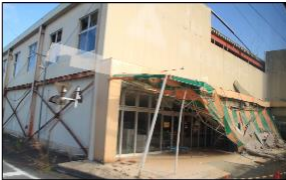
震災の被害がそのままの浪江町商店街
